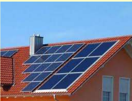
Φωτοβολταϊκά πλαίσια στη στέγη κατοικίας
