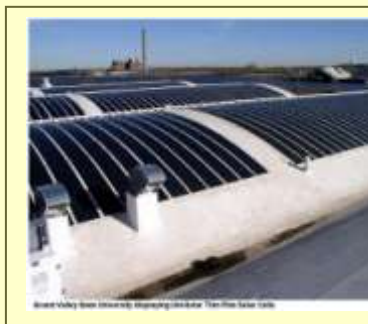
ΕΥΚΑΜΠΤΑ ΦΩΤΟΒΟΛΤΑΪΚΑ ΣΤΟΙΧΕΙΑ ΓΙΑ ΤΗΝ ΠΑΡΑΓΩΓΗ ΗΛΕΚΤΡΙΣΜΟΥ
