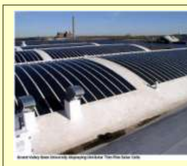
ΕΥΚΑΜΠΤΑ ΦΩΤΟΒΟΛΤΑΪΚΑ ΣΤΟΙΧΕΙΑ ΓΙΑ ΤΗΝ ΠΑΡΑΓΩΓΗ ΗΛΕΚΤΡΙΣΜΟΥ
